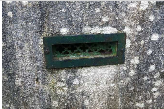
Grille à remplacer
