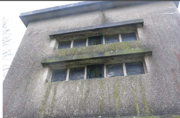
Baie vitrée sur la chambre de vannes du réservoir (carreaux cassés et grilles à remplacer)
