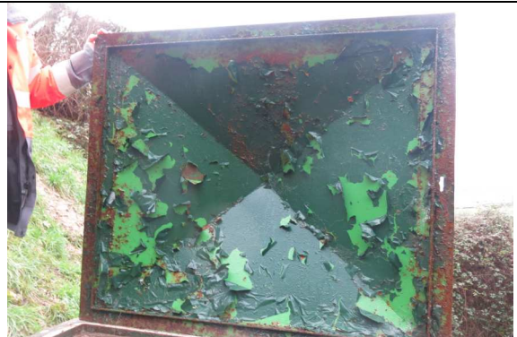
Capot en acier fermant la galerie de captage vétuste à remplacer
